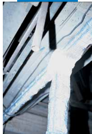
Struttura in calcestruzzo degradato
