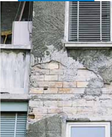
Edificio degradato che necessita di un intervento di recupero
