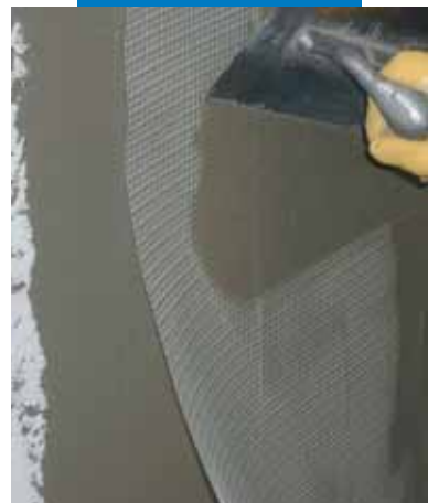
Rasatura dei pannelli termoisolanti armata con Rete in Fibra di Vetro annegata nello strato di Mapetherm AR1
