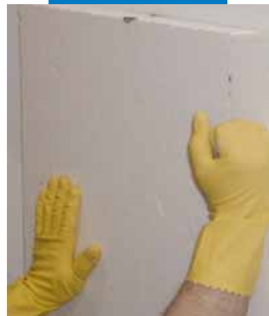
Pressatura dei pannelli dopo la posa per garantire la buona adesione al supporto
