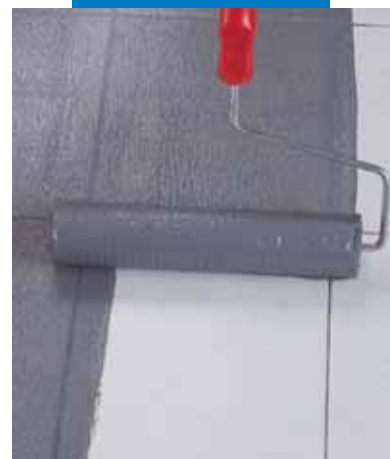
Applicazione a rullo di Eco Prim Grip su pavimento preesistente in piastrelle di gres porcellanato
