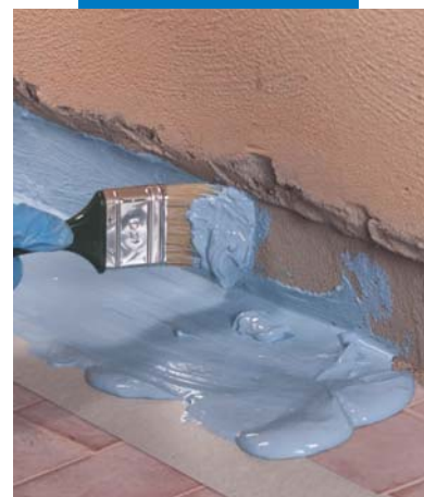
Stesura a pennello di Mapelastic® AquaDefense nel raccordo parete-pavimento, prima dell'applicazione di Mapeband
