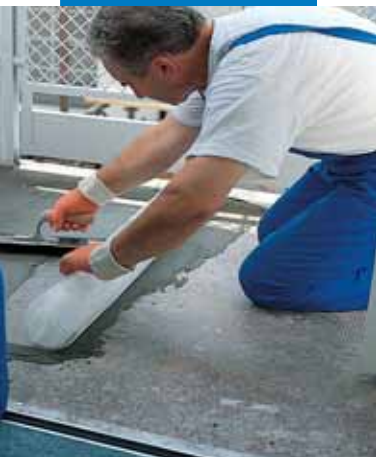
Impermeabilizzazione di un balcone con Mapelastic con applicazione di una rete di rinforzo in fibra di vetro
